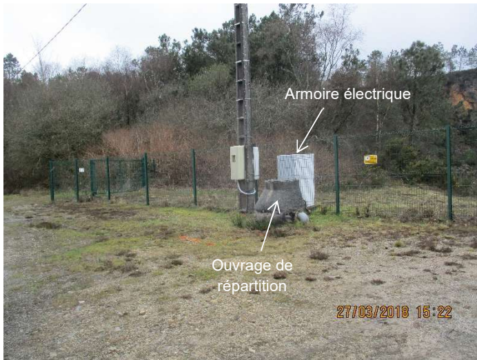
Figure 13 : Vue du regard de répartition et de l'armoire électrique de la réserve Barazer
